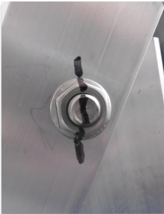
1. Tornillo con marca de inspección
